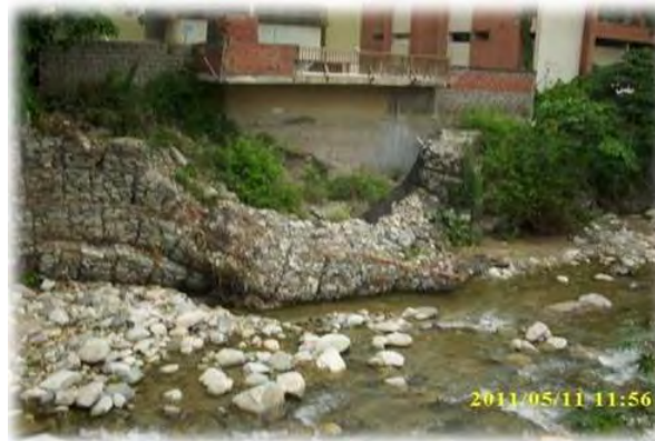
Foto 7.27. Colapso de la canalización de Cerro Grande en mayo de 2011. Fuente: CPCMS, 2013.
