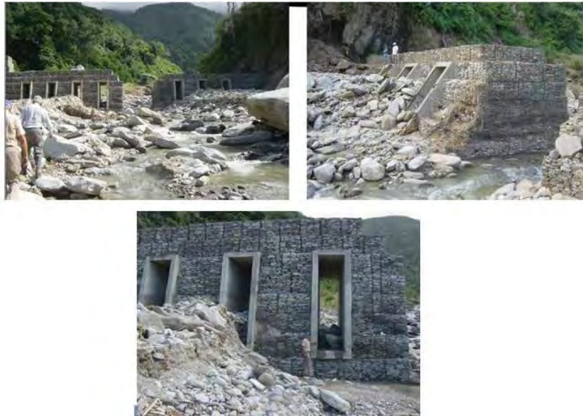
Fotos 7.2, 7.3 y 7.4. Afectación de la presa de Camurí Chico en febrero de 2005. Fuente: López, 2007
