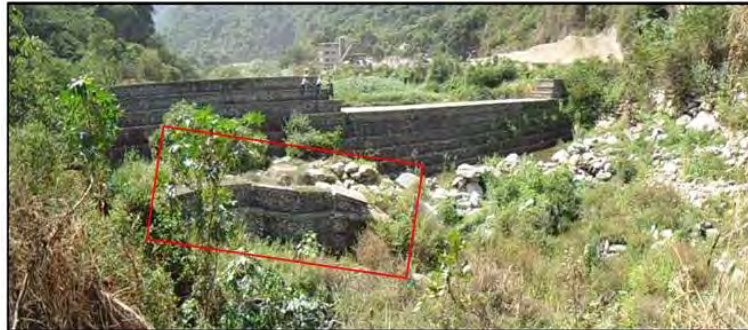
Foto 7.21. Afectación en contradique en la Presa N° 1. Fuente: León, 2011
