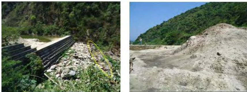
Foto 7.22 y 7.23. Afectación en contradique en la Presa N° 1 y Sedimento removido. Fuente: León, 2011
