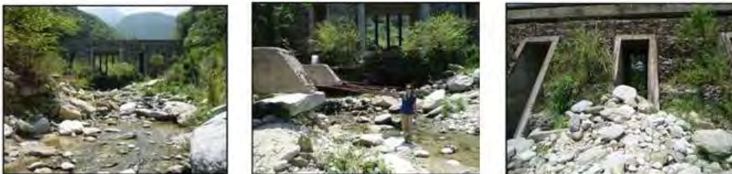
Fotos 7.8, 7.9 y 7.10. Estado de la presa de la cuenca de Camurí Chico en el 2008. Fuente: León, 2011
