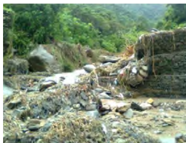
Foto 7.18. Colapso de contradique en 2011. Fuente: CPCMS, 2013
