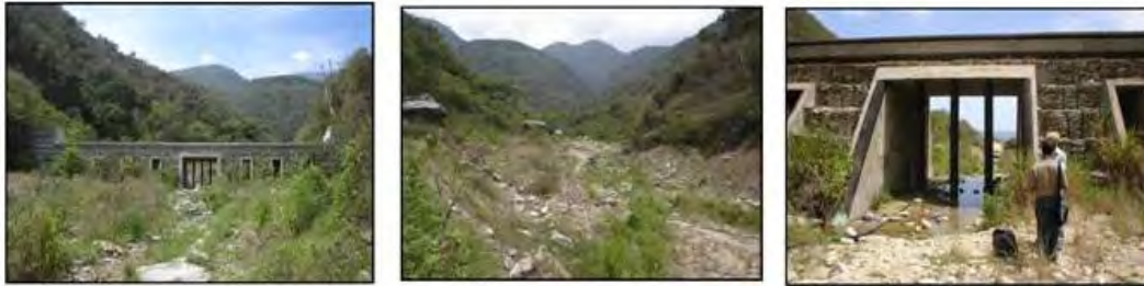
Fotos 7.5, 7.6 y 7.7. Estado de la presa de la cuenca de Camurí Chico en el 2008. Fuente: León, 2011
