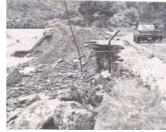
Foto. 4.13. Afectación El Piache. Fuente: La Verdad, 2010
